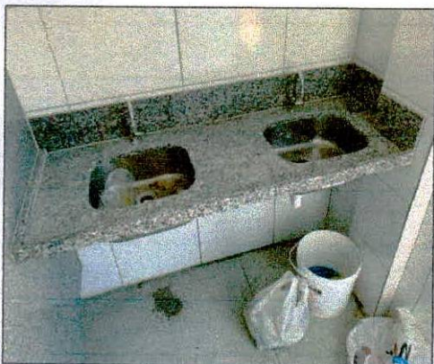
Foto 17: Cubas de metal e torneiras instaladas.
