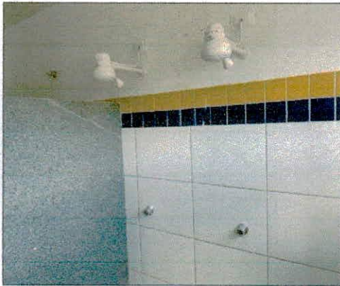
Foto 19: Chuveiros elétricos e registros instalados.
