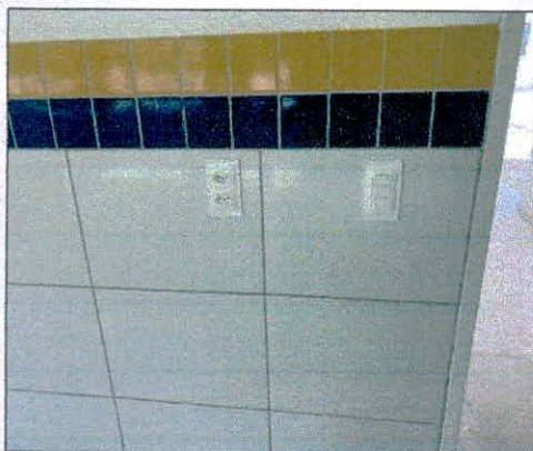
Foto 11: Interruptores, tomadas e instalados.
