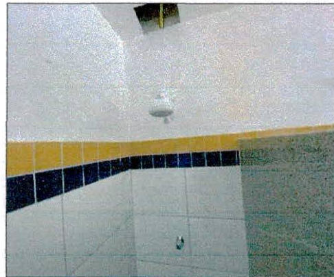
Foto 20: Chuveiros elétricos e registros instalados.
